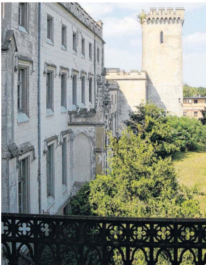
Der Nordturm ist nach einem Einsturz des Daches vor ein paar Jahren besonders kaputt. FOTOS: VEREIN VARCHENTINER SCHLOSS E.V.
